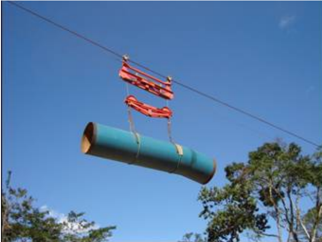
Fotografía 5.1 Vista de la tubería que está siendo trasladada por teleférico. Cortesía: R. Tormo
