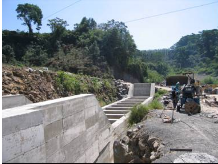
Fotografía 3.1 Movimiento de tierras para la excavación de canales y disposición adecuada del material excedente
